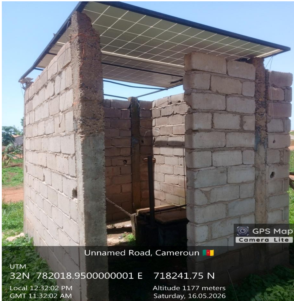
Photo 10 : Forage avec installation de 02 panneaux solaires en cours de réhabilitation par Zenith Mining dans la localité de Mayo Darlé Mine, et dont les travaux sont en arrêt.
