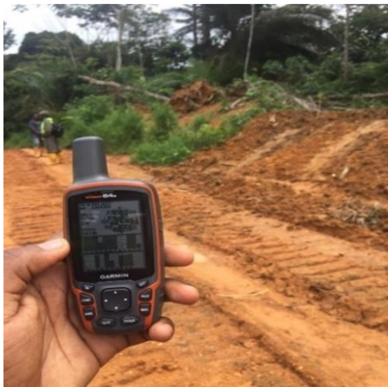
Photo 12 : Entrée piste d'exploitation hors limite de la VC 09 03 473 ; Coordonnées GPS 32N X : 663617 ; Y : 309391
