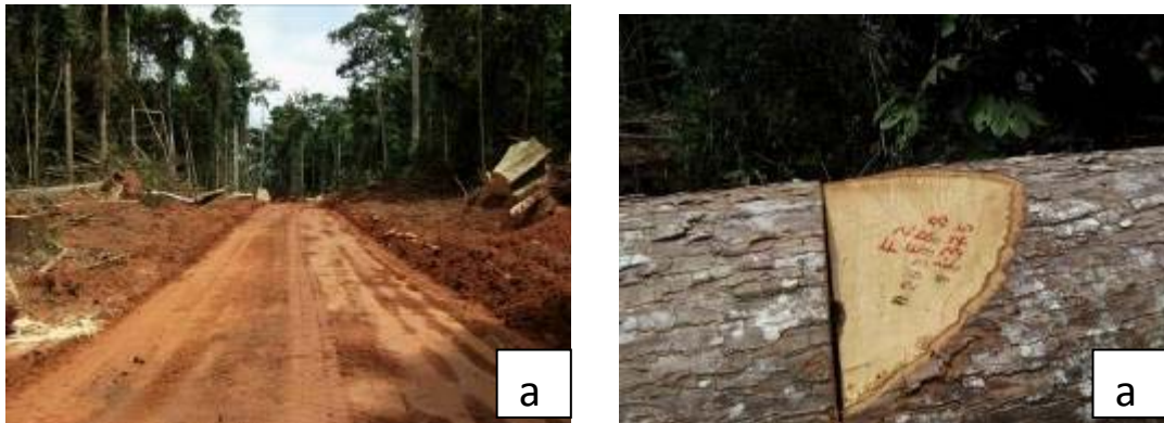
Fig. 26. Route d'accès à la VC 10 04 027 (a) et arbre déssouché marqué (b).
